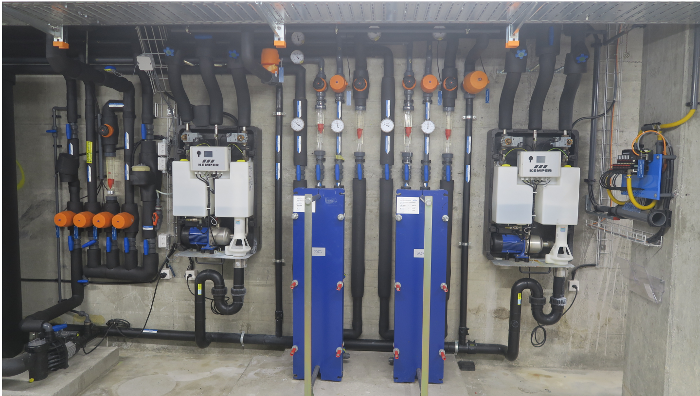
Abb. 13: Anlage Bafilco AG / Kemper Anlage
